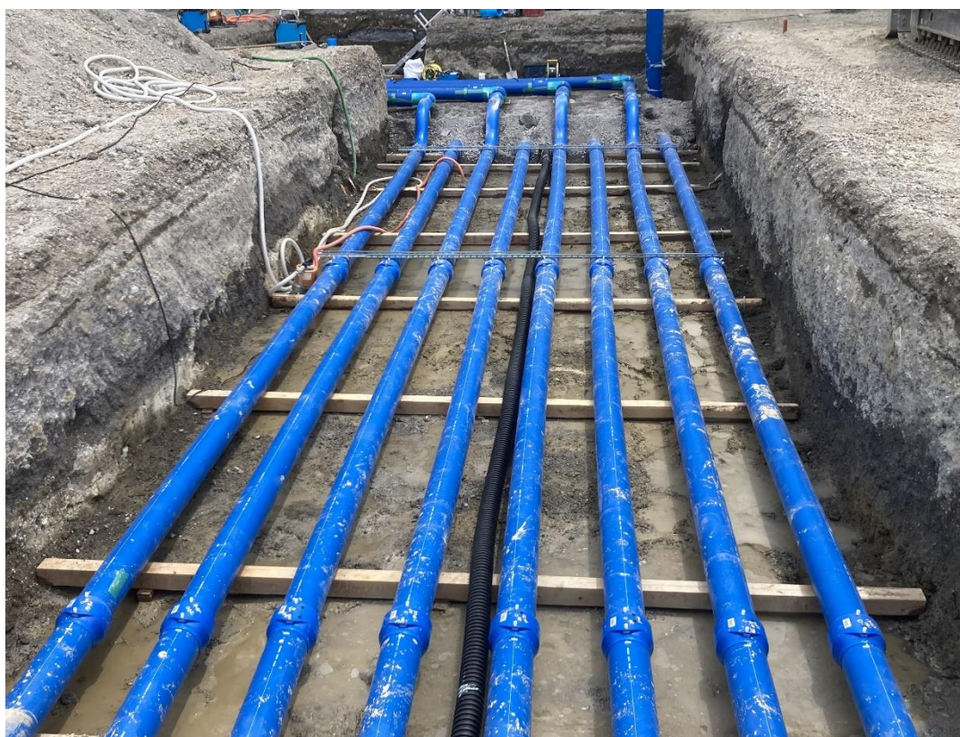
▲FC の下で稼働する地中熱交換システム（地表付近）
